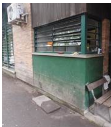
Figura 1. Marca da enchente na sede administrativa.
