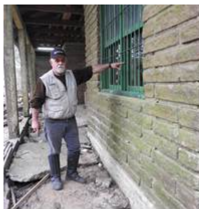
Figura 2. Avarias da enchente na "casa de pedra".
