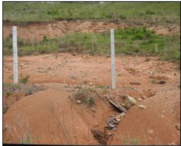
Foto 16. Erosão do solo.
