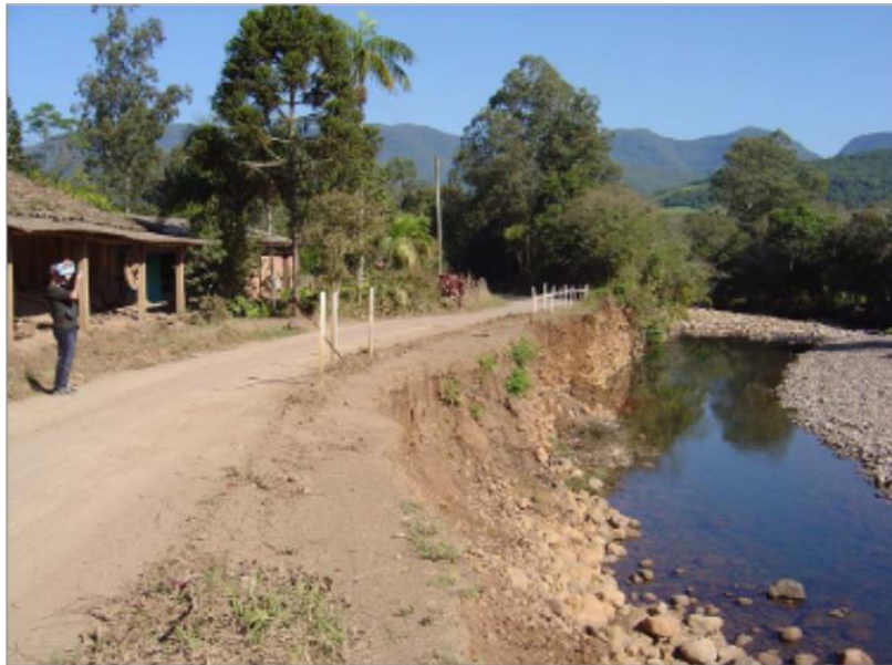
Figura 5: Erosão na margem do rio Três Forquilhas na localidade de Pedras Brancas. Fonte: Vieira, 2008, p. 99
