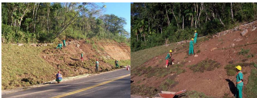
Figura 36: Fotografias de funcionários da empresa responsável por esta parte da estrada RST 486 reconstruindo o talude, após um movimento de massa do tipo rastejo.
