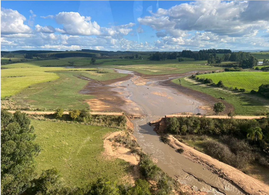
Figura 9: Vista de jusante para montante da barragem, com destaque para a área central de rompimento do maciço (-31,0023° S / -52,6153° W) sob responsabilidade da SDR-RS (Canguçu/RS).
