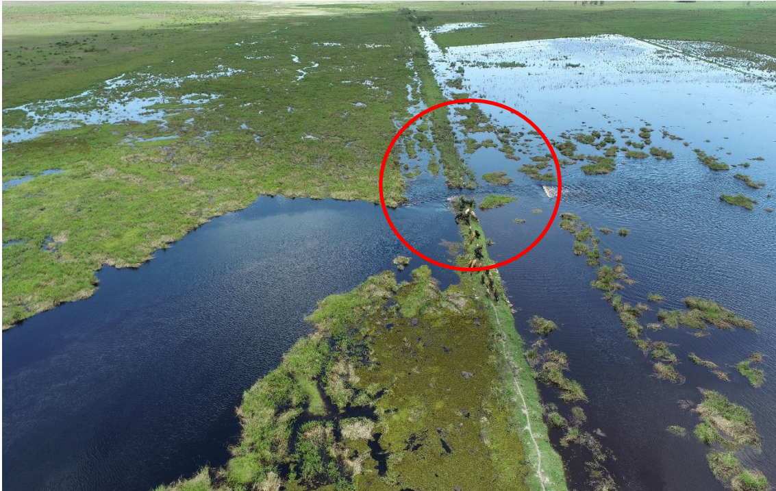
Figura 11: O círculo em vermelho mostra a área de rompimento do maciço lateral em péssimas condições de manutenção.
