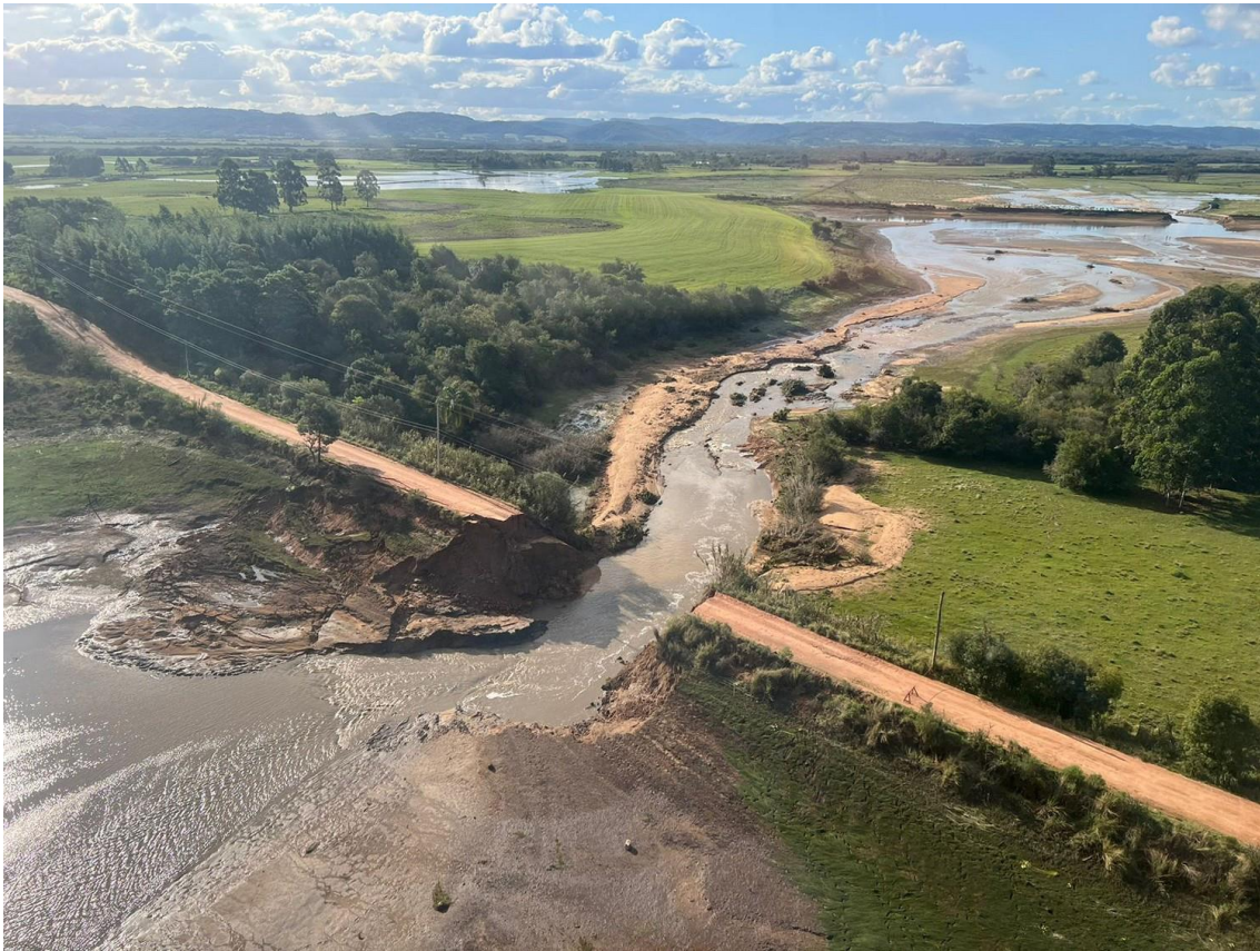
Figura 8: Visão aérea do rompimento das duas barragens em cascata sob responsabilidade da SDR-RS (Canguçu/RS).
