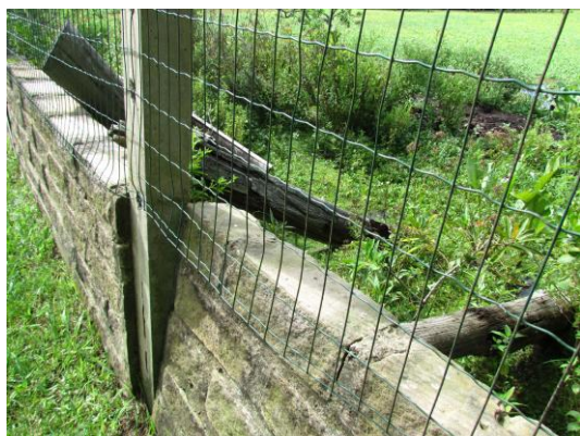
Foto 9. Parte danificada do muro do Mantenedouro de Fauna Silvestre.
